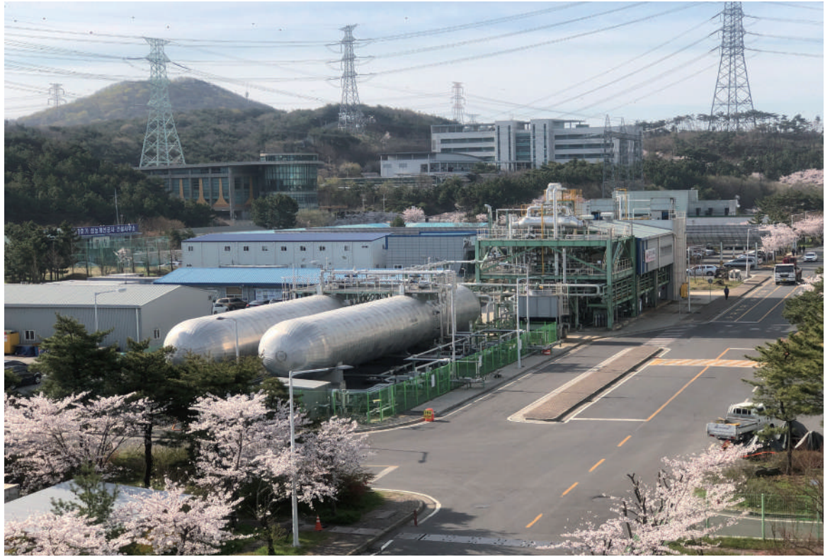
10MW급 KoSol CO 2 압축·액화설비.
