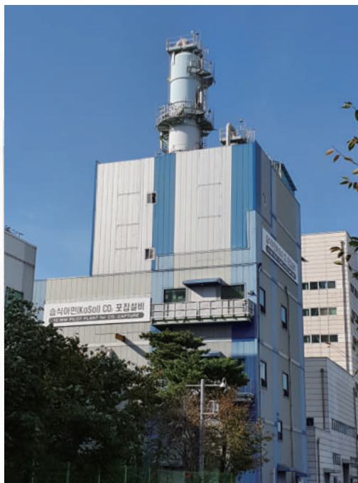
(왼쪽) 10MW급 KoSol CO 2 포집 설비. (오른쪽) 한국전력공사 전력연구원 전경.
