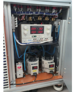
장비 내 설치 사진
